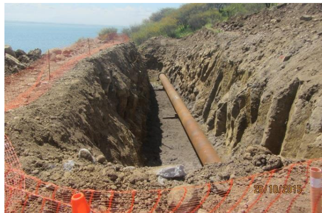
Zanja lado aguas arriba de la Presa Principal con Spool N° 4 de Tubería 700 mm.
