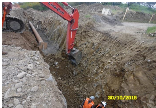
Excavación Zanja Sifón Santa Adela en el Coronamiento de la Presa Principal.
